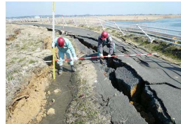
河川堤防への被害(茨城県東茨城郡茨城町)
