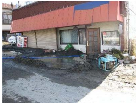
建物への被害(千葉県我孫子市)
