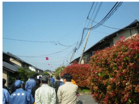
電柱の傾斜(茨城県潮来市)
