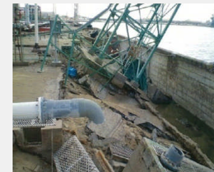
港湾設備の被害
