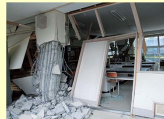
地震により崩壊した教室の柱 (福島県本宮市)
