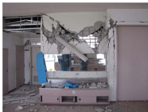
【小学校の損壊】
