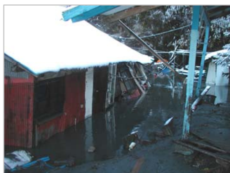
【津波による住宅の損壊】
