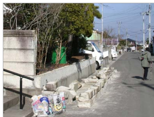
【住宅への被害】
