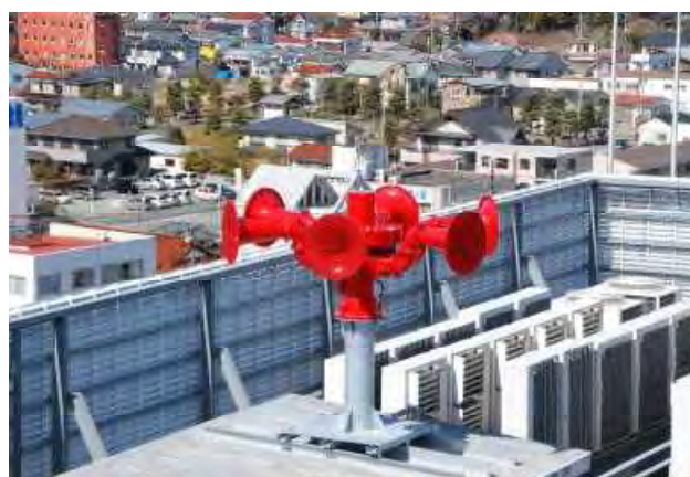
復興ビル屋上に設置したモーターサイレン
